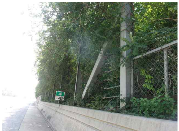
도로부, 낙석방지울타리 전경
