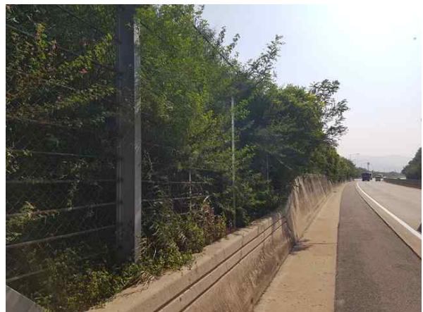
도로부 낙석방지울타리 전경
